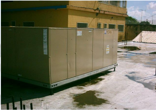
EQUIPO A/A COMPACTO DE 30 TR.CALABOZO, EDO. GUARICO
