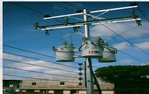
ALTA TENSION. TRANSFORMADORES. CALABOZO, EDO. GUARICO
